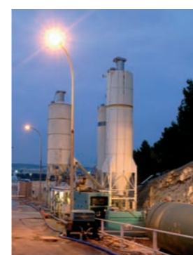
GEOGAZ à Lavéra (13)
